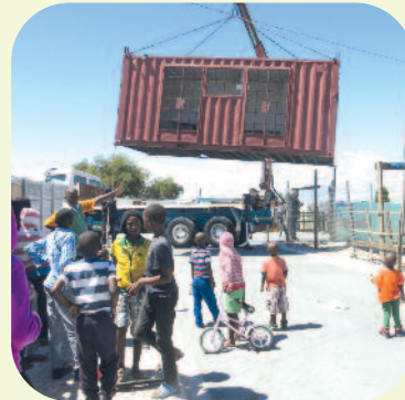
Eine logistische Meisterleistung: Die Seecontainer müssen auf die beengten Parzellen gesetzt werden. Foto: Matchbox South Africa
