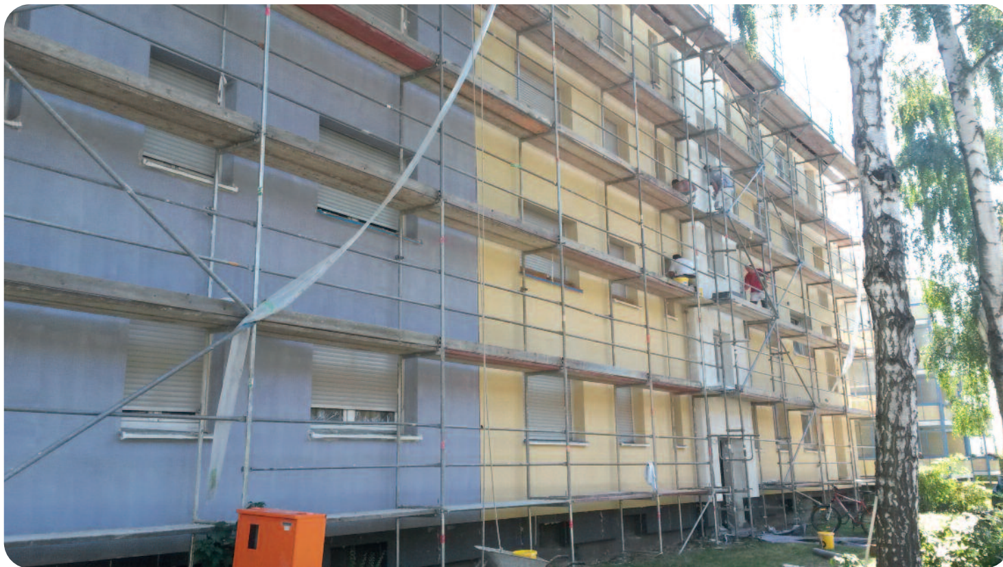
Im laufenden Jahr setzt die Gartenstadt-Genossenschaft u.a. die Verbesserung und Aufwertung ihrer ältesten Nachkriegsgebäude (Baujahr 1956) fort. Im Sylter Weg 6-10 werden Fassade und Dach wärmegeklämt und neue Fenster installiert. Außerdem werden Balkone angebracht. Nach Fertigstellung wird die Außenanlage neu gestaltet.
